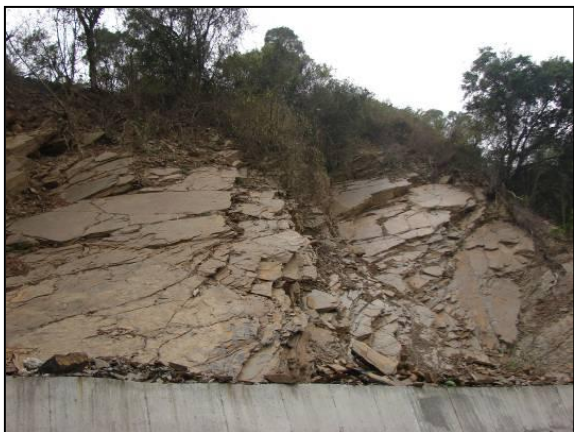
圖4 平面型崩塌為層面或是其他不連續面上之表層風化岩屑或土壤，沿著岩盤面向下坡運動。照片中表層由於節理發達，岩盤被切得很破碎，向右方傾倒後再向下坡運動，而非坡趾出露造成的滑動破壞，常被誤判成順向坡滑動。若當岩盤風化程度更進一步，有可能發生弧形崩塌。整治方法同陡坡崩落整治方法。
