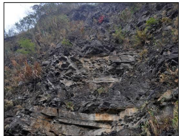
圖1 落石主要發生在陡坡，材料為岩石，由至少兩組以上節理切割岩盤，造成岩石以自由落體、彈跳或是滾動的運動方式向下坡運動，並在坡腳形成崖錐堆積，且多發生在砂頁岩差異侵蝕之區域，變質岩區域亦常見到落石。多以混凝土噴漿或是掛網植生等方式穩定坡面。
