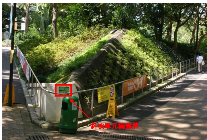
圖 2 人工斜坡登記編號 Fig.2 A serial number of man-made slope unit
